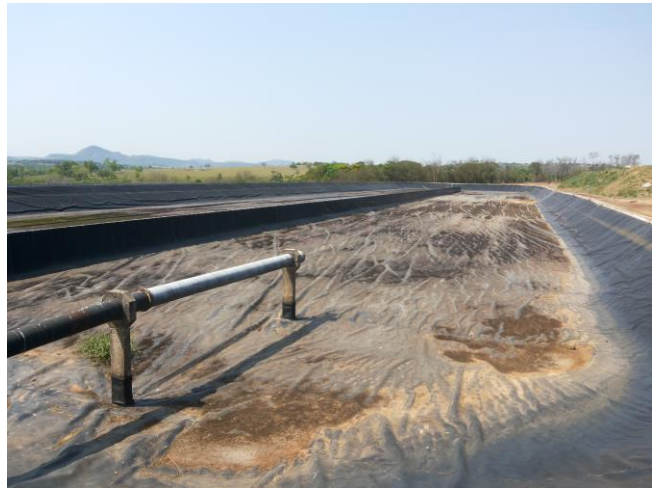
Figura 7 – Lagoa Facultativa 2 desativada.
