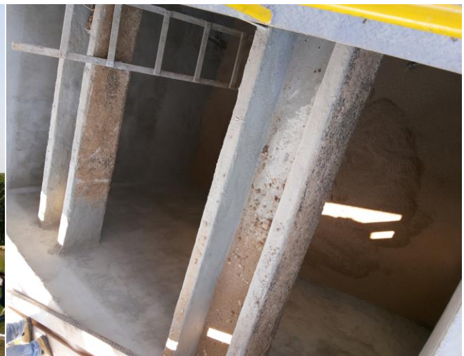
Figura 9 – Filtros passando por manutenção.
