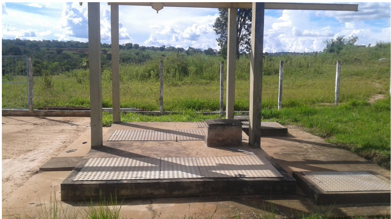
Foto 14. Caixa de bombas de recalque para encaminhamento do efluente - 25/02/2015.
