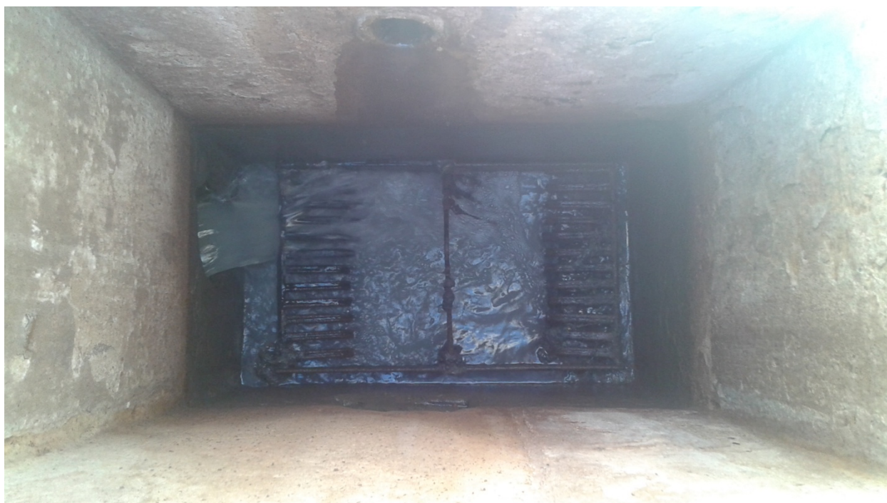
Foto 12. Ponto de recebimento do efluente (gradeamento) - 25/02/2015.
