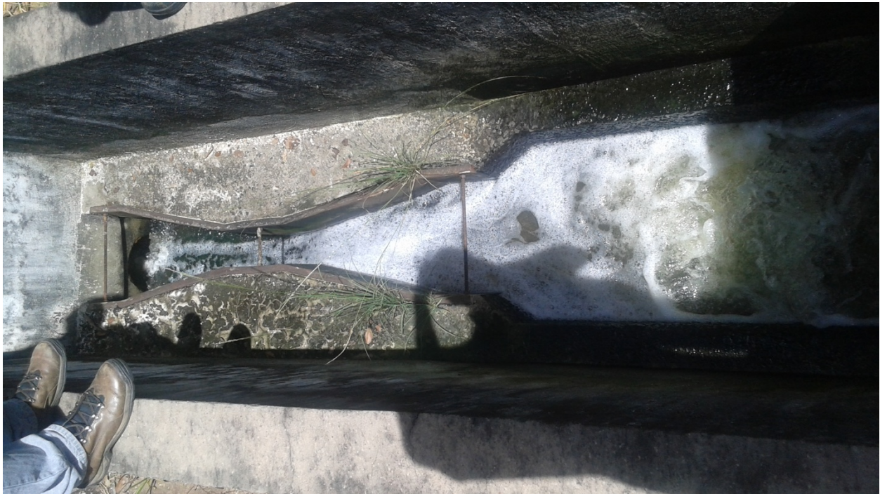
Foto 23. Medidor de Vazão de saída (Calha Parshall) - 25/02/2015.
