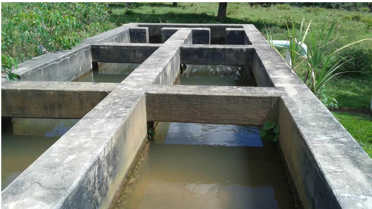
Figura 27. Desarenador. Fonte: TERRA Consultoria, Estudos e Projetos Ambientais, 2015.
