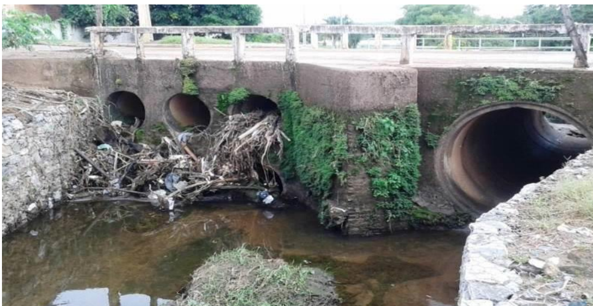
Figura 15. Entupimento de galerias pluviais. Fonte: TERRA Consultoria, Estudos e Projetos Ambientais, 2015.
