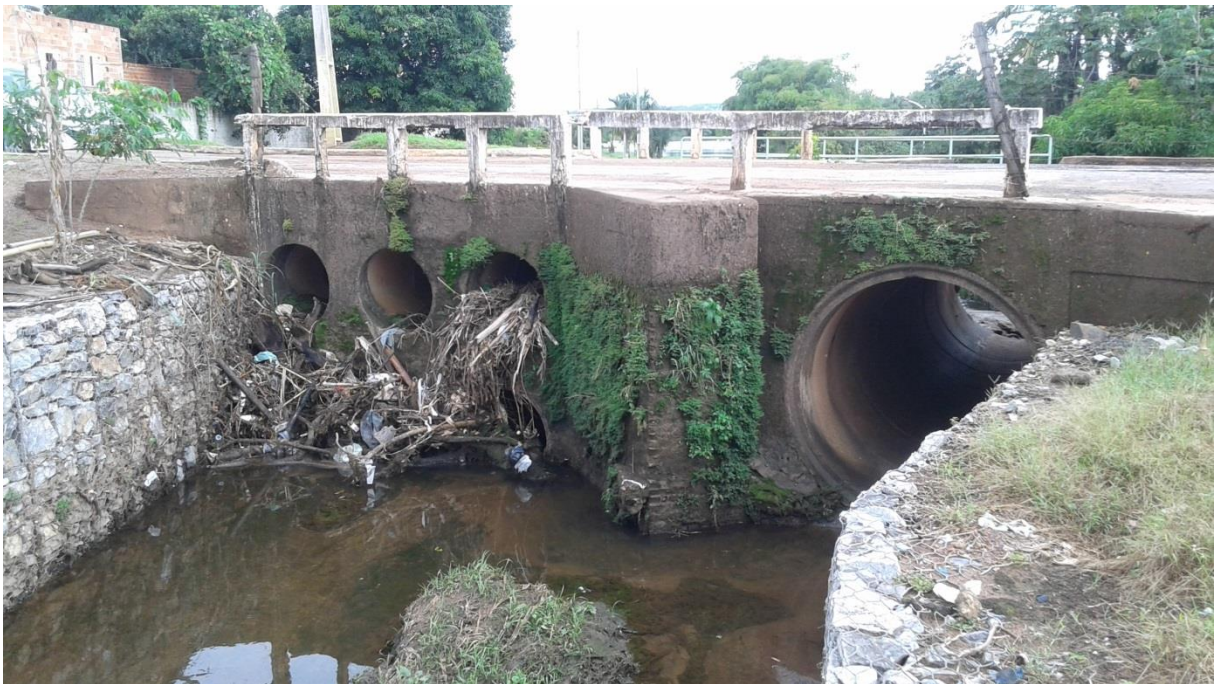
Figura 84. Ponte da Rua 11 - Ponto de alagamento. Fonte: TERRA Consultoria, Estudos e Projetos Ambientais, 2015.
