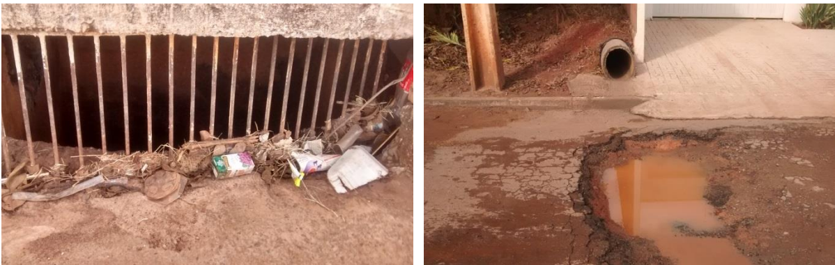
Figura 82. Acumulo de lixo e canalização inadequada – Av. Mário J. Vieira e Rua Joaquim S. Ferreira. Fonte: TERRA Consultoria, Estudos e Projetos Ambientais, 2015.
