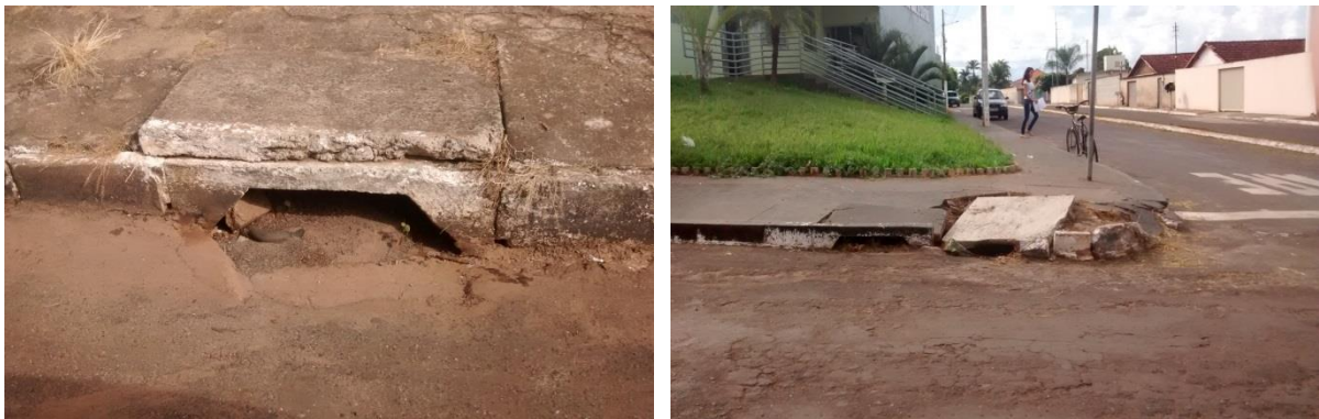
Figura 79. Obstrução e falta de manutenção e limpeza em bocas de lobo – Av. Plínio Gayer Fonte: TERRA Consultoria, Estudos e Projetos Ambientais, 2015.
