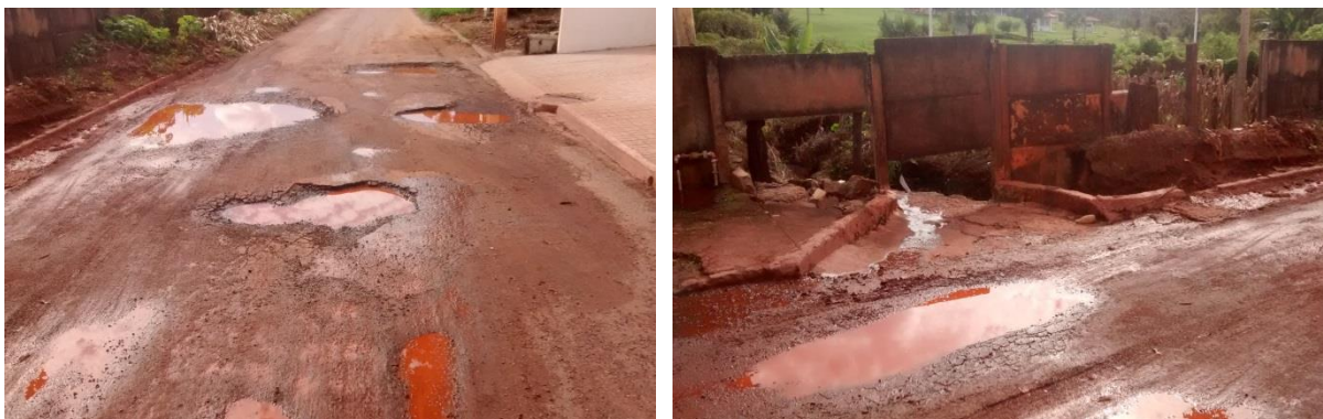
Figura 80. Falta de manutenção na via e nas sarjetas - Rua Joaquim S. Ferreira Fonte: TERRA Consultoria, Estudos e Projetos Ambientais, 2015.
