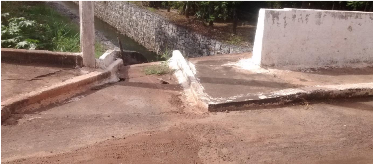
Figura 74. Sarjetão usado para encaminhar o efluente ao canal de captação. Fonte: TERRA Consultoria, Estudos e Projetos Ambientais, 2015.
