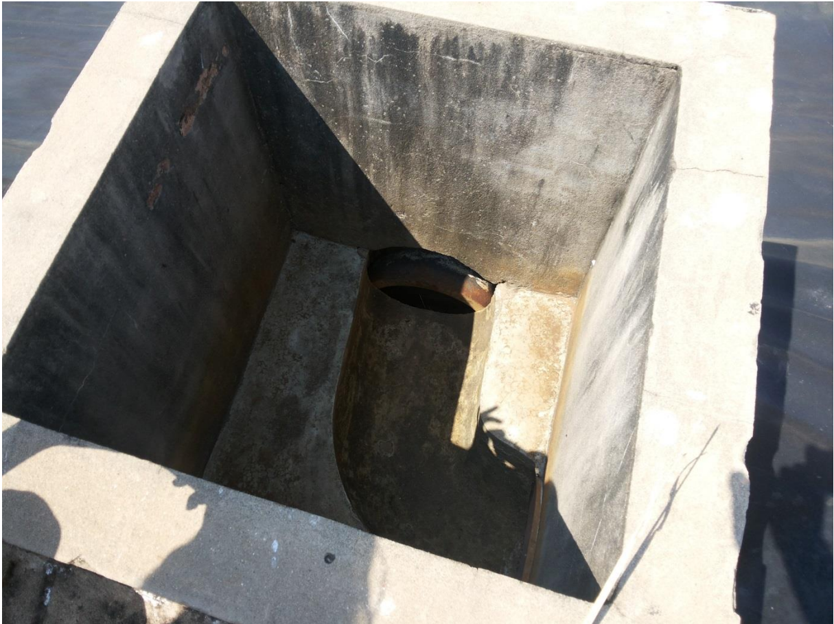
Figura 58. Deslocamento do duto e rompimento da manta na lagoa facultativa 1. Fonte: TERRA Consultoria, Estudos e Projetos Ambientais, 2015.
