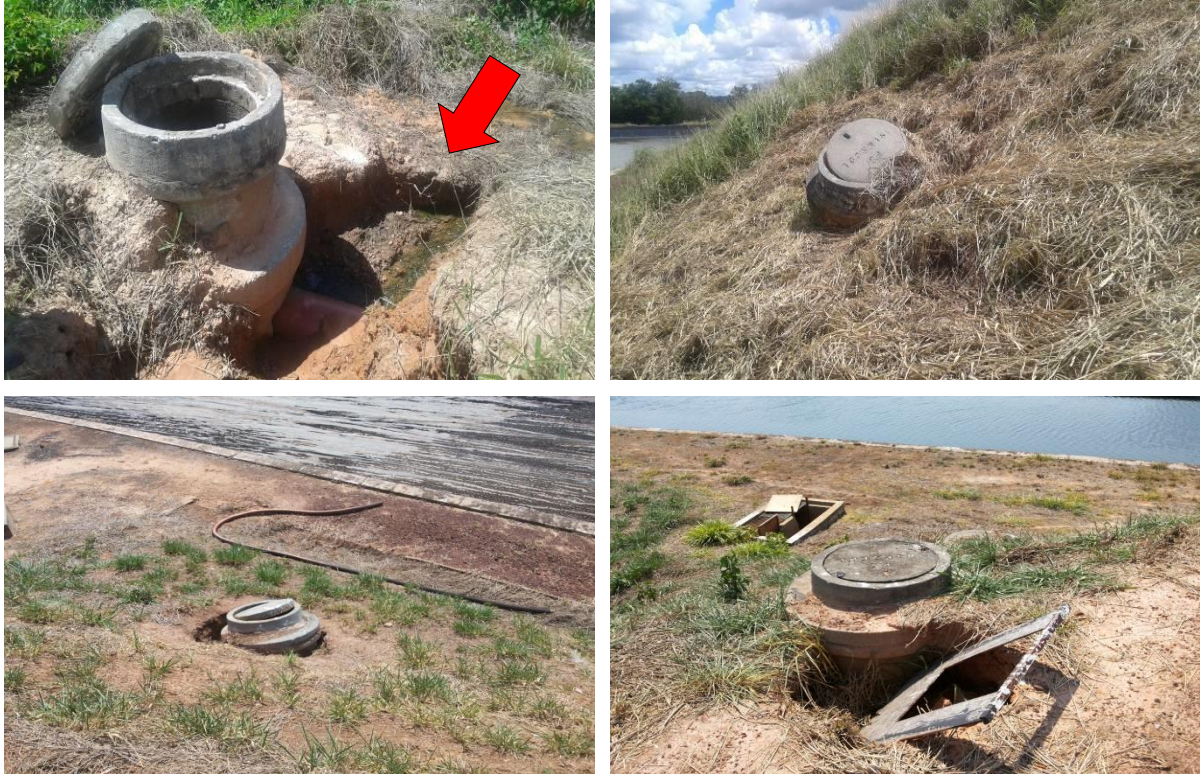
Figura 57. Poços de visita com problemas estruturais. Fonte: TERRA Consultoria, Estudos e Projetos Ambientais, 2015.
