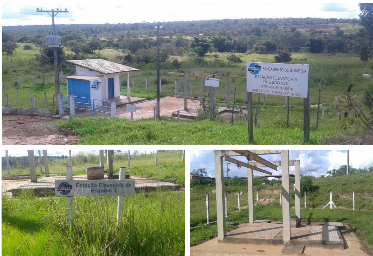
Figura 44. Estação Elevatória de Esgotos - EEE I Fonte: TERRA Consultoria, Estudos e Projetos Ambientais, 2015.
