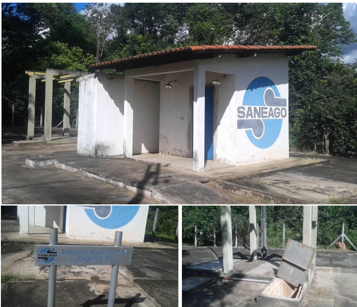
Figura 45. Estação Elevatória de Esgotos - EEE II Fonte: TERRA Consultoria, Estudos e Projetos Ambientais, 2015.
