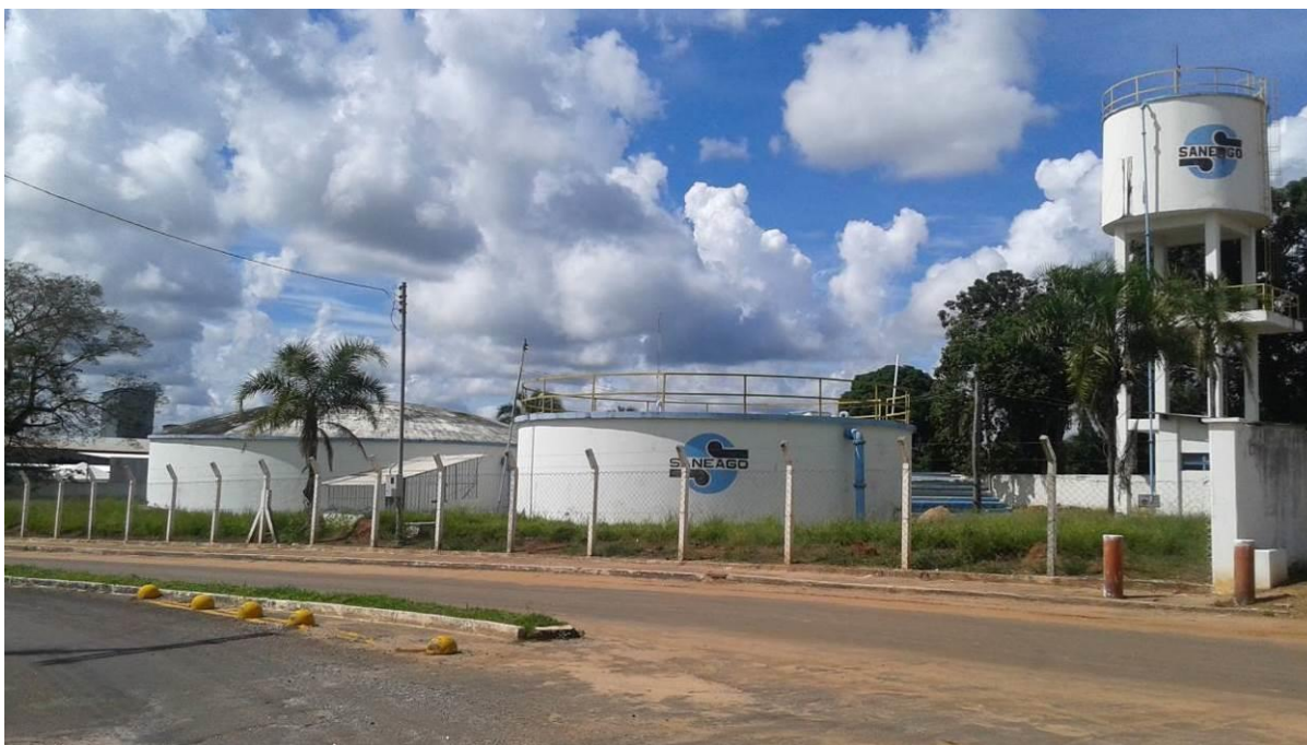
Figura 34. Visão Geral do Centro de Reservação. Fonte: TERRA Consultoria, Estudos e Projetos Ambientais, 2015.
