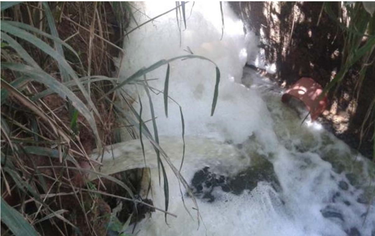
Figura 74. Saída do efluente tratado no Rio Bonito - 25/02/2015.
