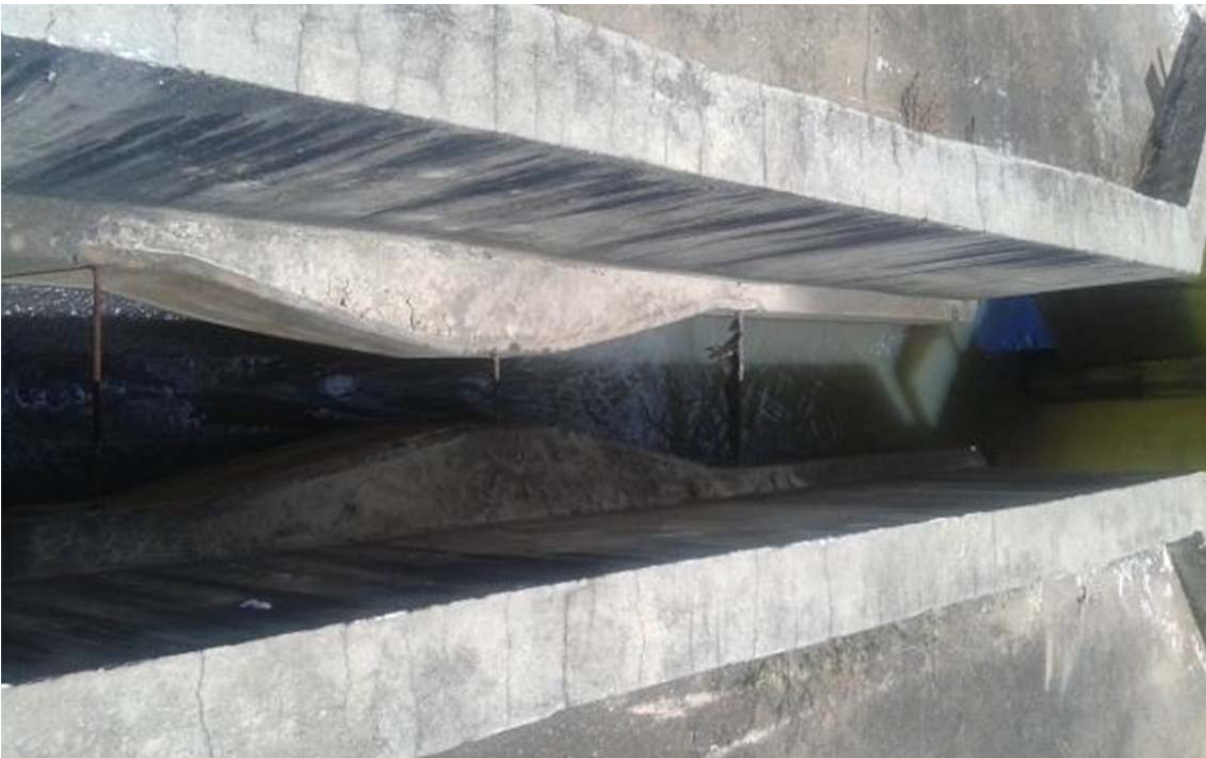
Figura 66. Calha Parshall - Medidor de Vazão (entrada do efluente) - 25/02/2015.
