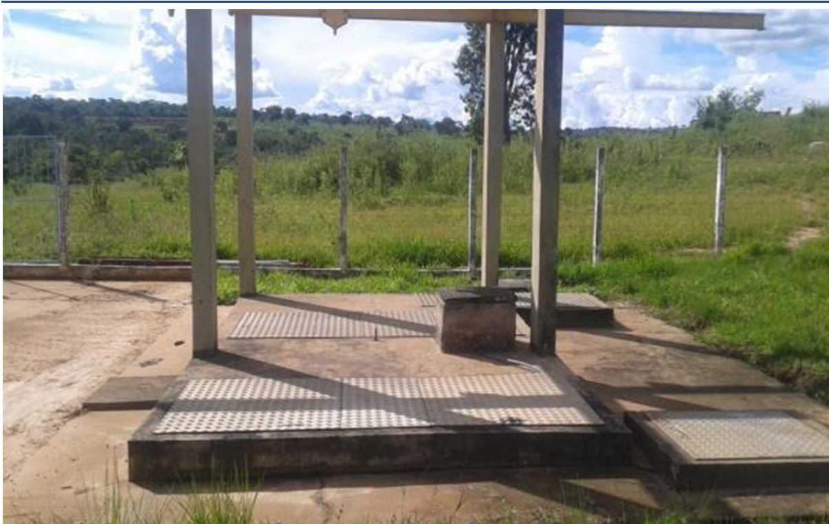
Figura 64. Caixa de bombas de recalque para encaminhamento do efluente - 25/02/2015.
