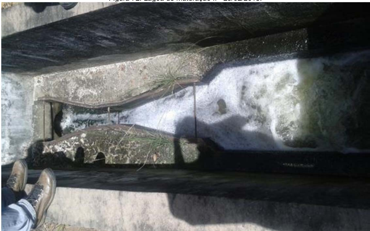
Figura 73. Medidor de Vazão de saída (Calha Parshall) - 25/02/2015.
