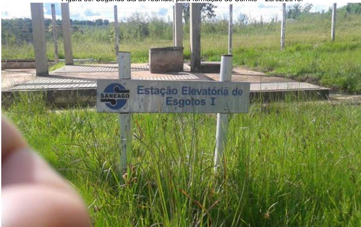
Figura 61. Visita técnica na Estação Elevatória de Esgoto I - 25/02/2015.
